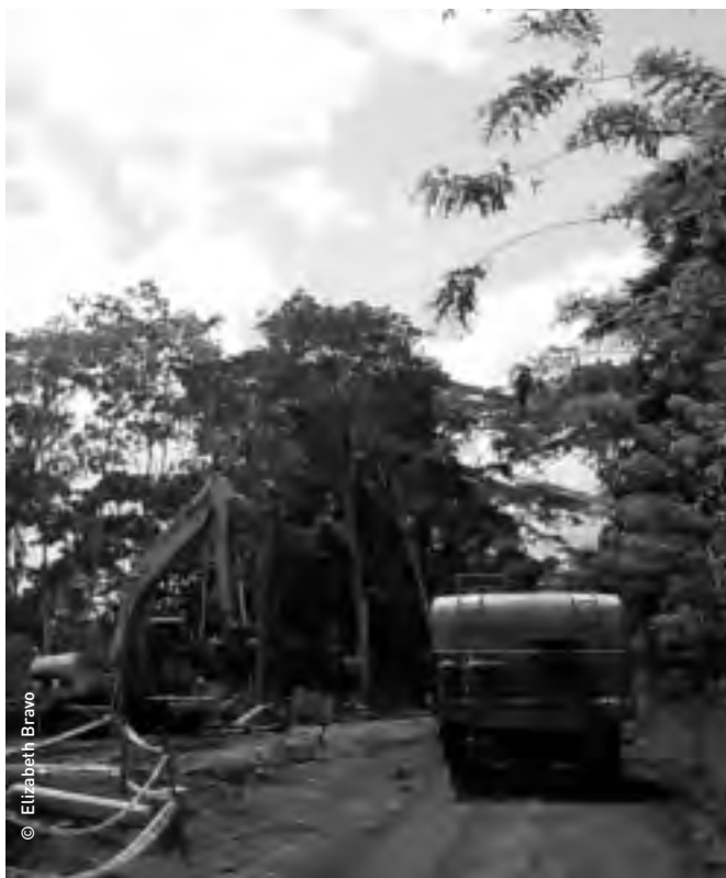
Infraestructura petroliera a l'Amazònia. Campo Palo Azul
